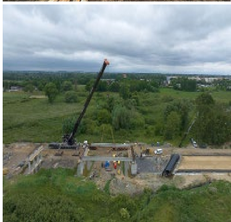
Fot. (góra) Stanowisko pod podpory żurawia o udźwigu 500 ton i montaż belek typu T (dół).
